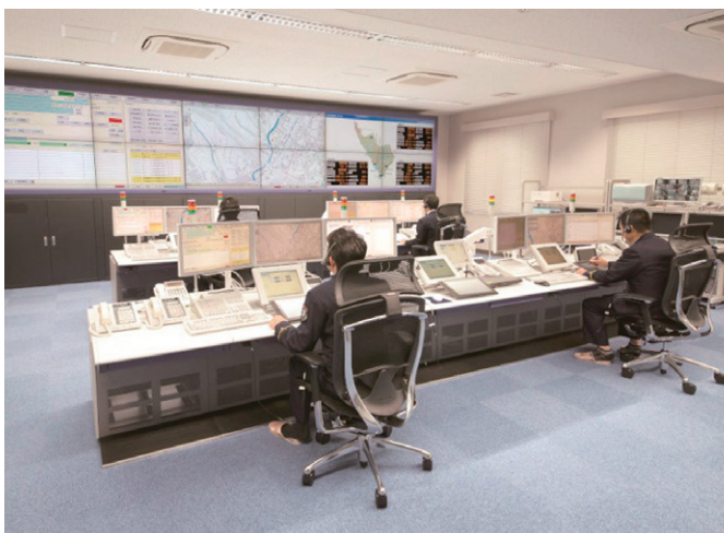
消防指令センター
